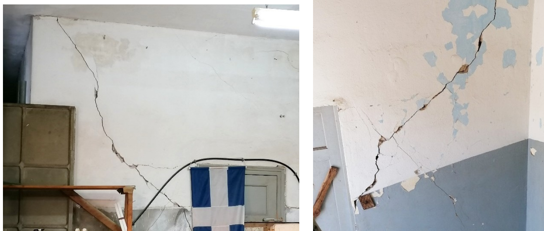
Εικόνα 10. Διαμπερής διατμητική ρωγή στον τοίχο του κλιμακοστασίου.
