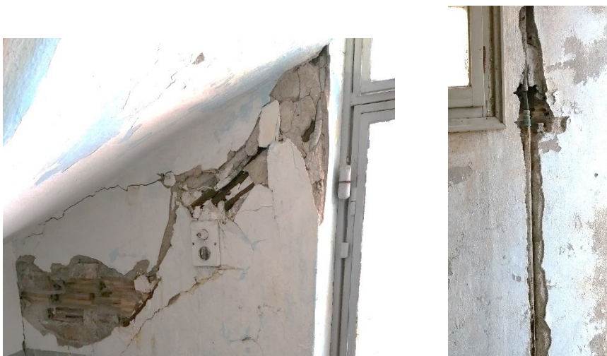
Εικόνα 9. Αποδιοργάνωση της τοιχοποιίας λόγω οξείδωσης των σωλήνων ύδρευσης.
