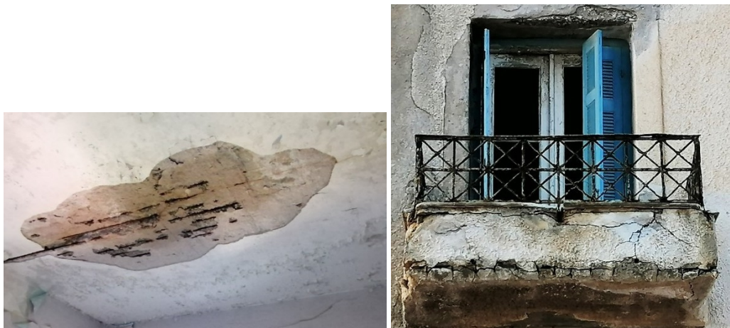
Εικόνα 13. Οξείδωση οπλισμών στις πλάκες του ορόφου και στους εξώστες.
