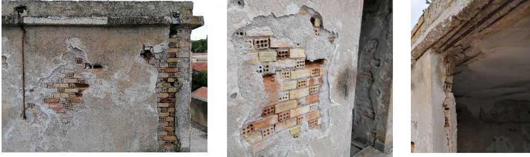
Εικόνα 12. Βλάβες στην μπατική τοιχοποιία και στην πλάκα οπλισμένου σκυροδέματος στο δώμα.
